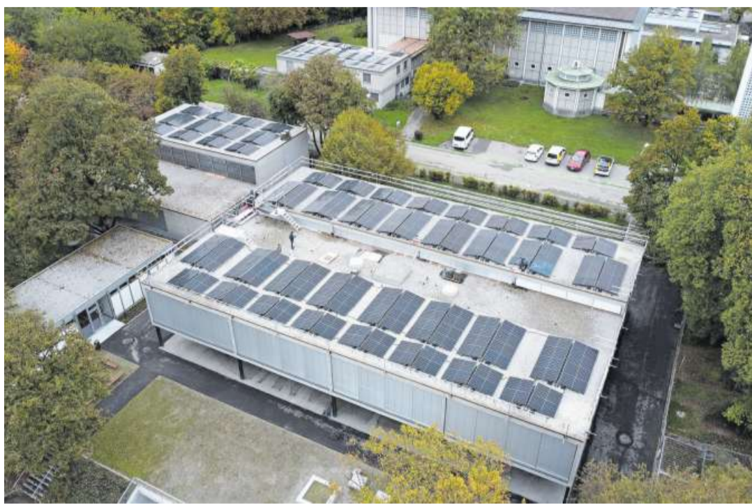
Seit den Herbstferien 2023 gibt es eine Solaranlage auf dem Schulhaus Wildbach.
